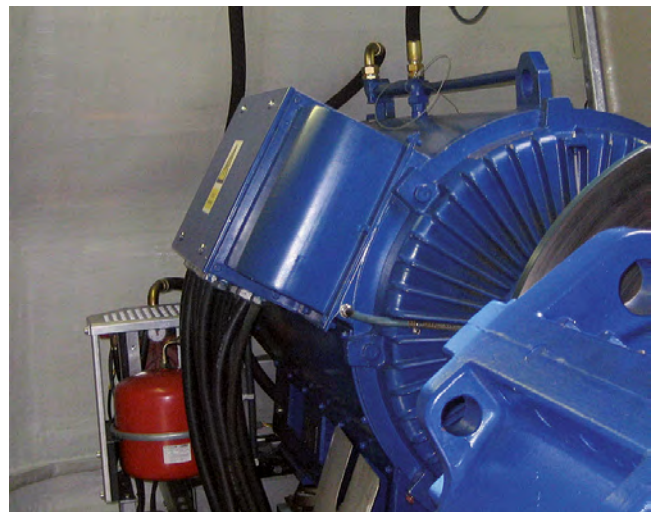
Generator in einer Windkraftanlage
